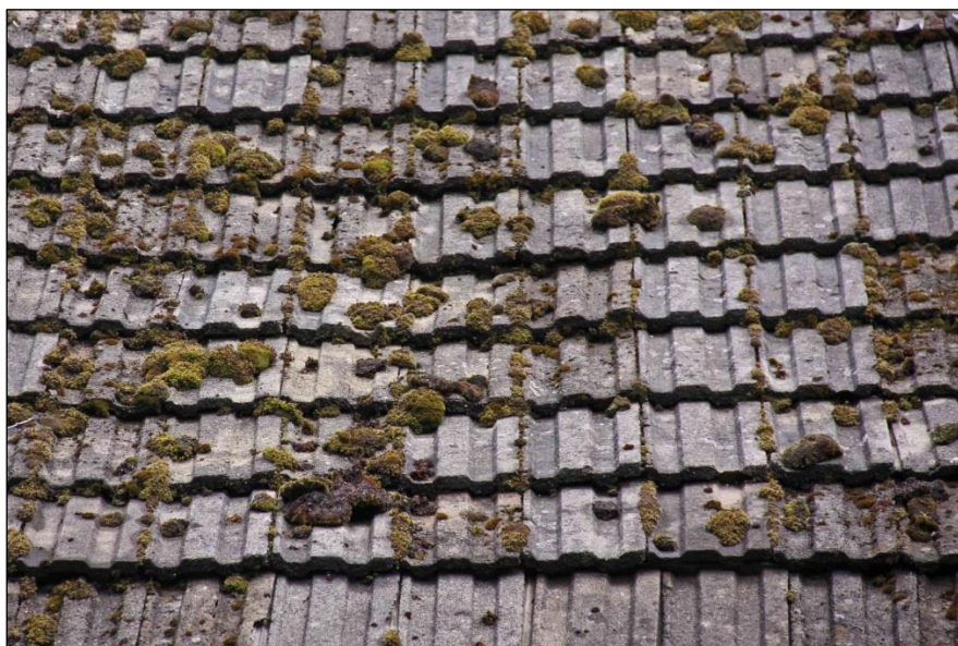
Dakvlak gedekt met cement muldenpannen. De worden op den duur poreus, wat de levensduur beperkt.
