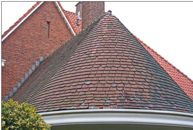
Een dak van een serre van een woonhuis uit circa 1930, belegd met leipannen in twee vormen. Door te weinig zijdelings overlap is de onderconstructie door lekkage sterk aangetast.
