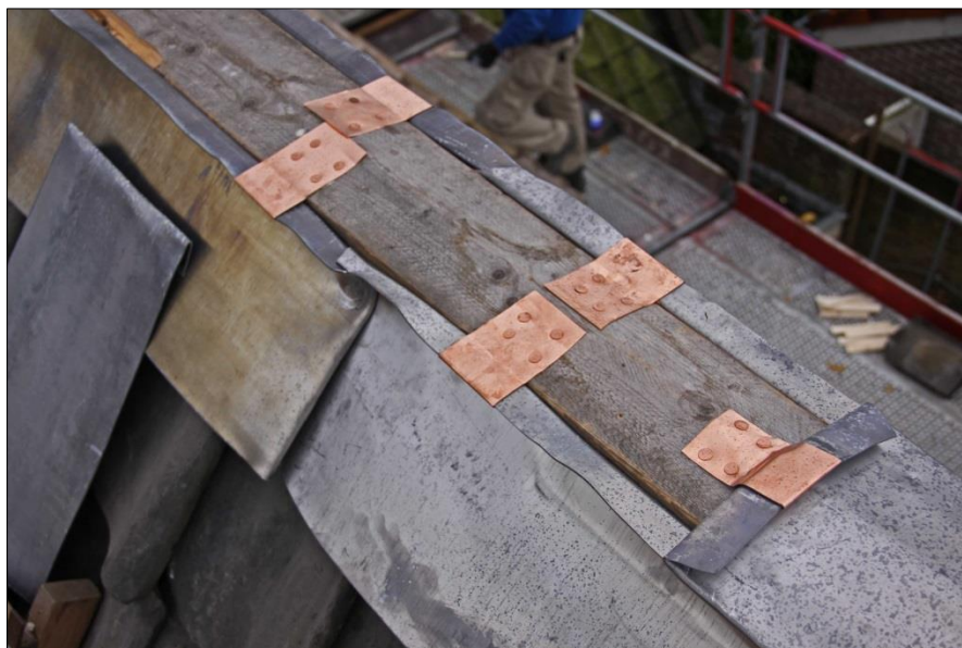
Noklood aangebracht in 3 delen van 25 kg/m 2 , vastgezet met koperen klagen. De delen zijn in lengtes van 1,0 meter verschervend aan elkaar gefelst.
